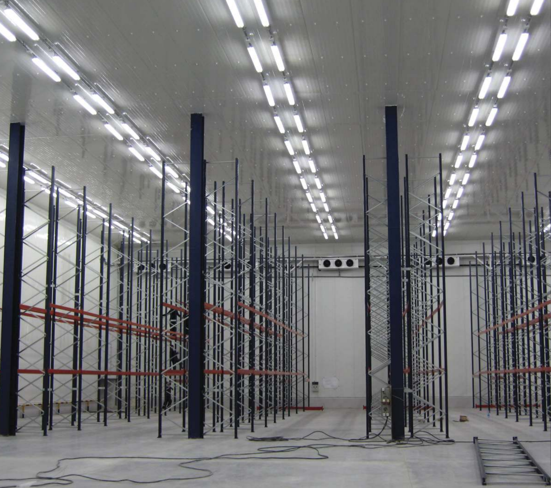
Складське приміщення, с. Гостомель. Обладнання: БСЗ "Люмен" | Storage facility. Gostomel. Equipment: Lumen Світлотехнічний дизайн-проект, поставка обладнання
